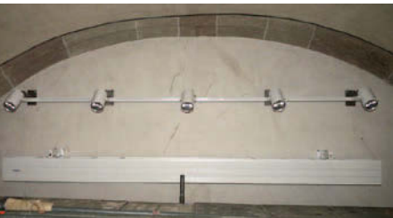
Lichtstrahler / Projektionsleinwand im Chorraum
