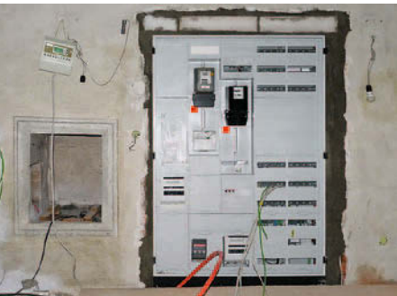
neuer Schaltschrank in der Sakristei
