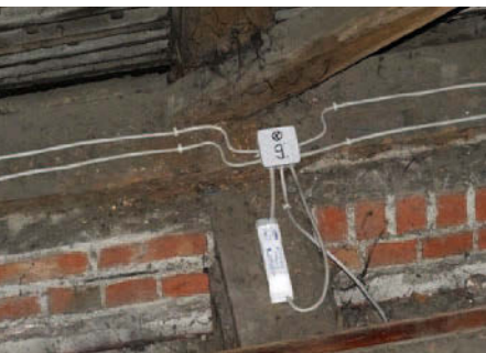
Verkabelung für neue Seitenwandstrahler
